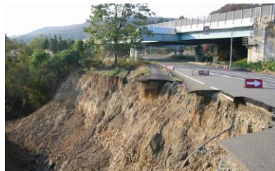
2004年新潟県中越地震M6.8 国道117号小千谷市塩殿
