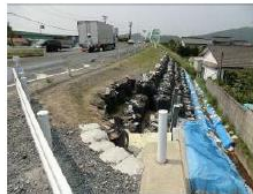
写真-10.28 被災箇所の状況(全景) (EPSの側壁パネルの柱が2本残されているが、前額が見られる。)
