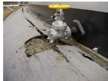
タンク沈下でバルブが基礎に接触 いわき市
