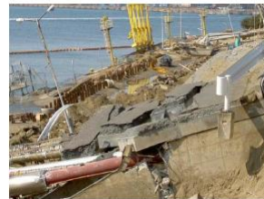
護岸被害 鹿島地区
