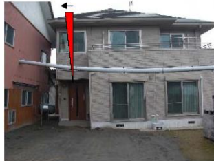
写真25 傾斜した住宅 建築研究所報告書
