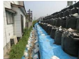
写真-10.29 のり尻部の状況 (近隣の家屋には変状は見られない)
