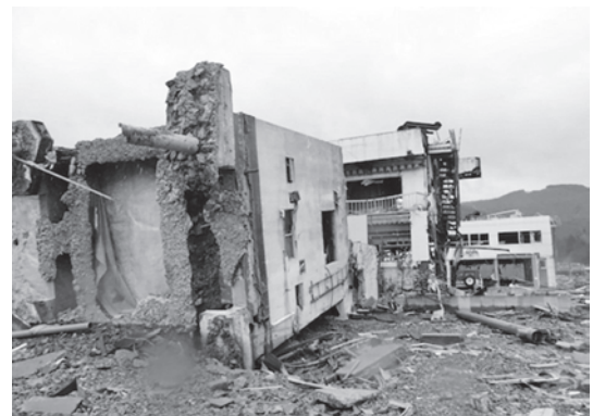
写真－3 女川町でのコンクリート建物被害。建物基礎の損傷が見られる（著者撮影）
