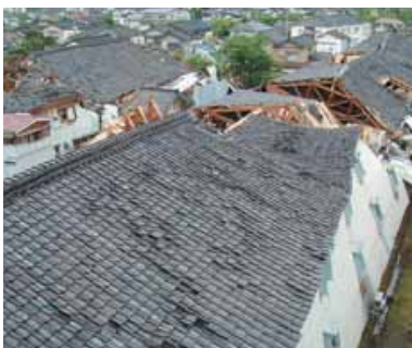
屋根が崩れ落ちた酒蔵の被害
