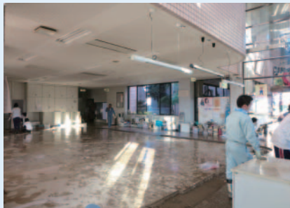
福知山市大江支所内部(約1.2m浸水)
