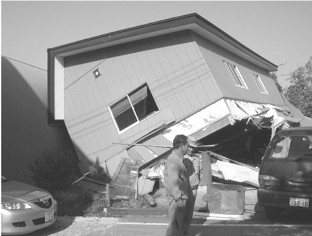
第2 - 4 - 1写真 新潟県中越地震で倒壊した住宅(新潟県川口町)
