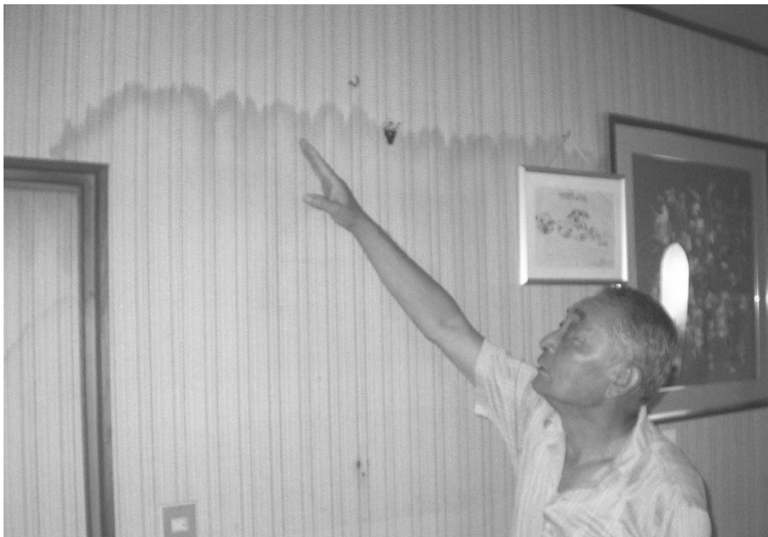
第2-6-1写真 東海豪雨の浸水跡が残る住宅(名古屋市)
