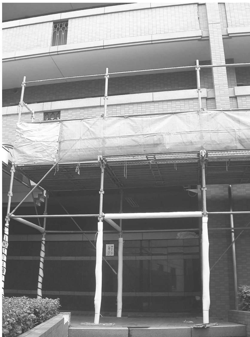
第2 - 5 - 3写真 福岡市内の被災マンション
