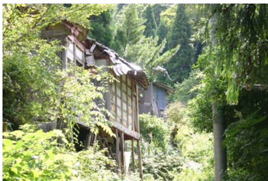
第 5-1-11 図 段の崩壊した建築
