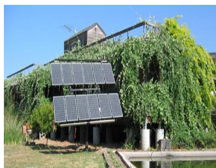
学内に設置されているソーラーパネル 2)
