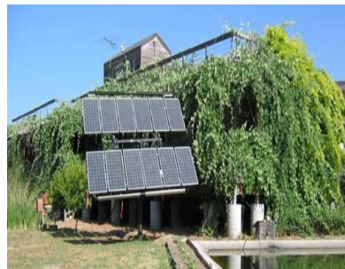
学内に設置されているソーラーパネル (69)
