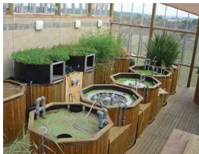
温室にある水質浄化装置 4)
