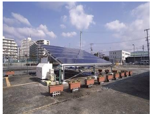
第 5-1-6 図 くるくる発電所に設置された太陽光発電パネル 出典：新星電気株式会社「太陽光発電施工事例」 http://www.shinsei-el.co.jp/taiyo/taiyo.html
