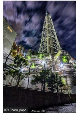
写真 高砂火力発電所 (高砂市)
