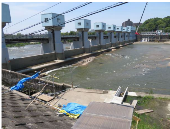
図 2-2-2 漏水中の明治用水頭首工
