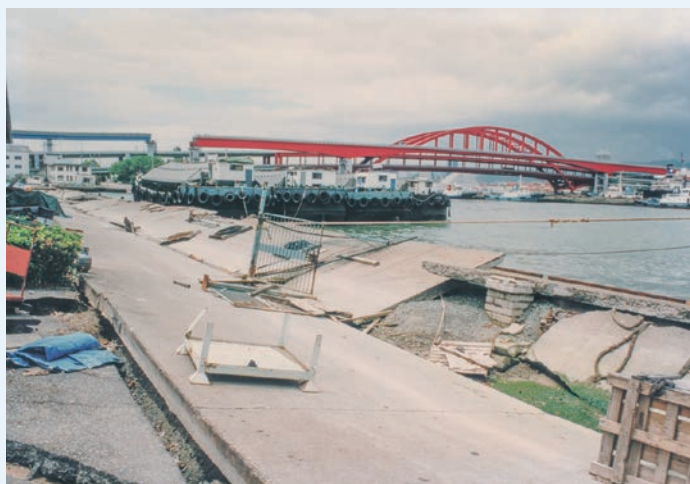
地震と液状化で割れた港 (0000578-001001-001.0020)
