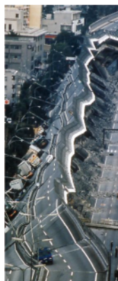
地震で倒壊した阪神高速神戸線
