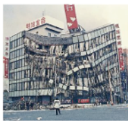
1階部分から押しつぶされるように倒壊した三貴銀行や明治生命などが入居するビル
