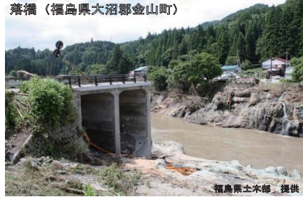
○只見川における浸水被害 (福島県大沼郡)
