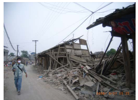
写真7 遵道鎮の被災状況
