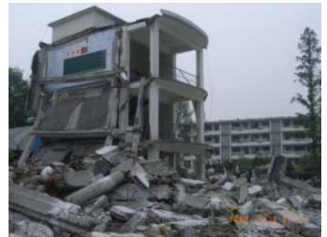
写真1 倒壊した聚源中の校
